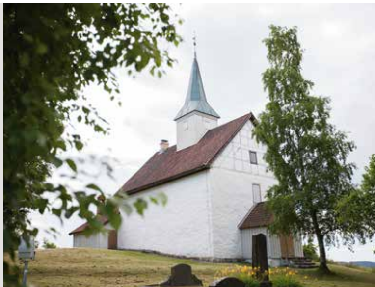
Forskarane skal finne tiltak for å redde Skoger gamle kirke. Kanskje må det takrenner til?
